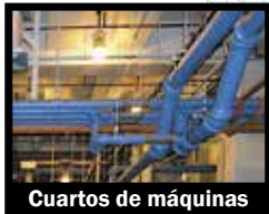
Cuartos de máquinas
